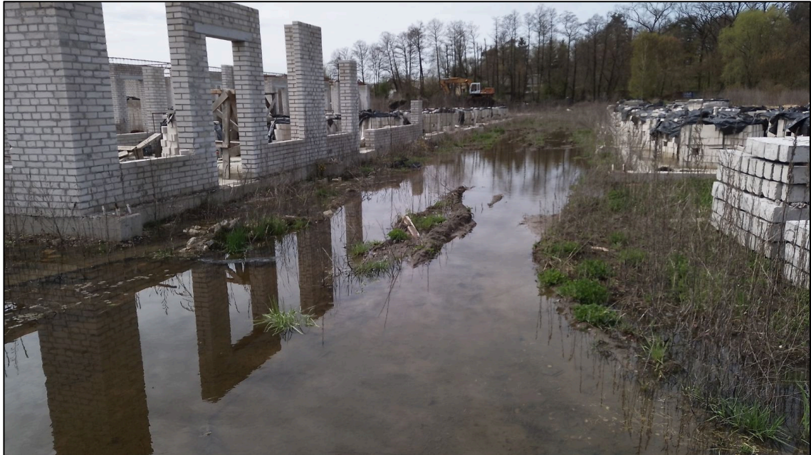
Рис. 3. Підтоплення ділянки заповни р.Ірпінь в місці планової забудови нового Ірпінського центрального ринку. 18.04.2023р. Фото автора.
